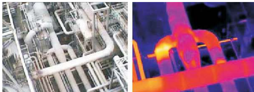
Figura-7-6. Tuberías en general. Tomada de http://www.serivenca.com.ve/servicios.html
