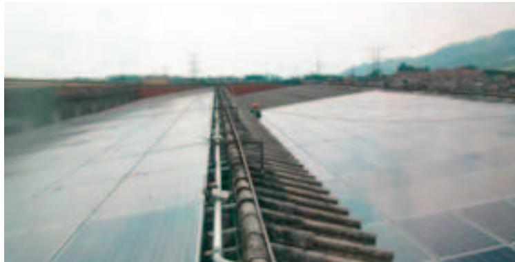
Figura 26. Arreglo de 104 KWde paneles solares en Nestle Colombia en Dosquebradas, Risaralda. Fuente: solentechnology.com
