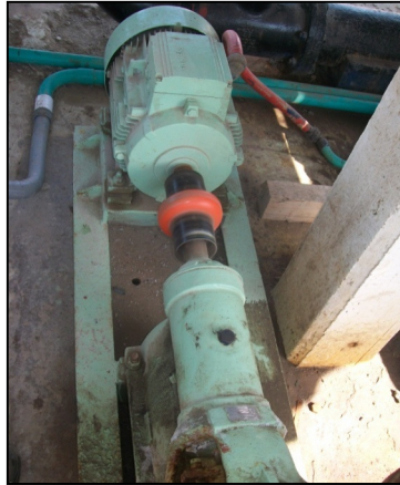
Figura 25. Motor suministro de bomba de agua
