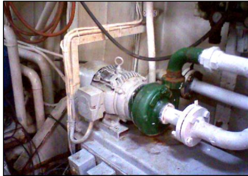
Figura 24. Motor Bomba enfriamiento de motor de combustión
