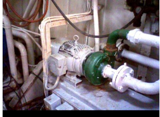
Fig. 1 Bomba de suministro de agua varadero
