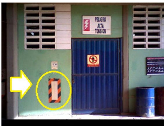
Fig. 15 Sub. 3 no hay equipo contra incendio
