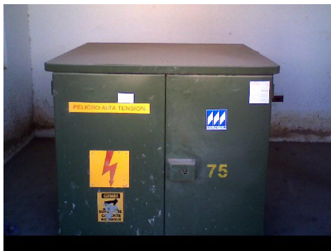
Fig. 1 Transformador de 75 KVA sub. 1
