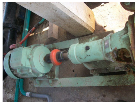
Fig 1. Bomba de suministro de agua varadero
