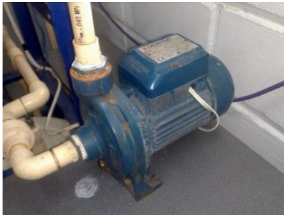
Figura 45. Bomba de agua caliente (parte superior)
