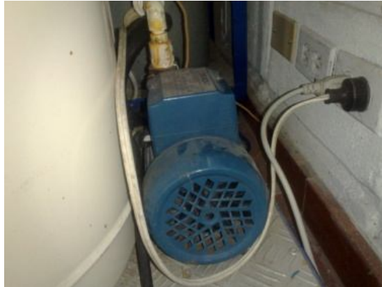
Figura 44. Bomba de agua fría
