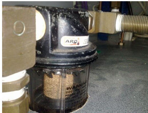
Figura 60. Filtro de aire.
