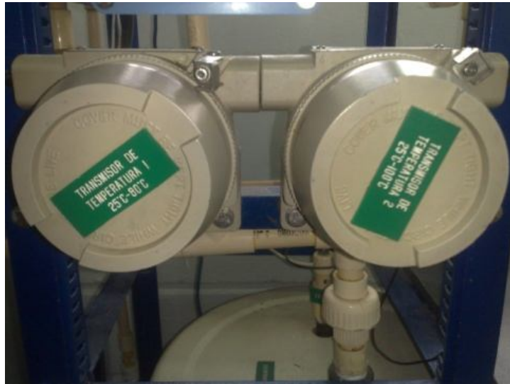
Figura 52. Transmisor de temperatura
