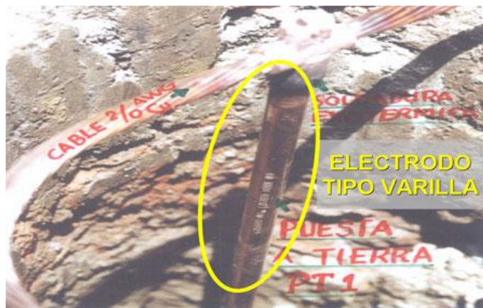
Figura 4. Fotografía de una puesta a tierra
