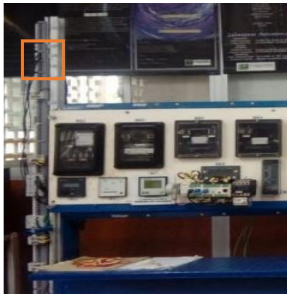
Figura. 29 Ubicación de bornera del relé GEK45375.
