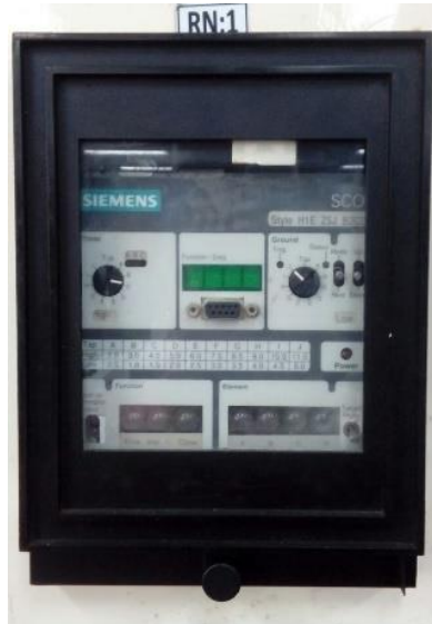
Figura. 5 Relé SCOR Siemens
