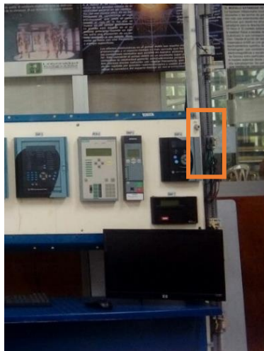
Figura. 34 Ubicación de borneras del relé SR-469.
