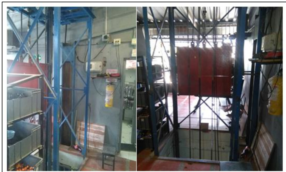
Figura 18. Condición de inseguridad en el ascensor. Elaboración propia
