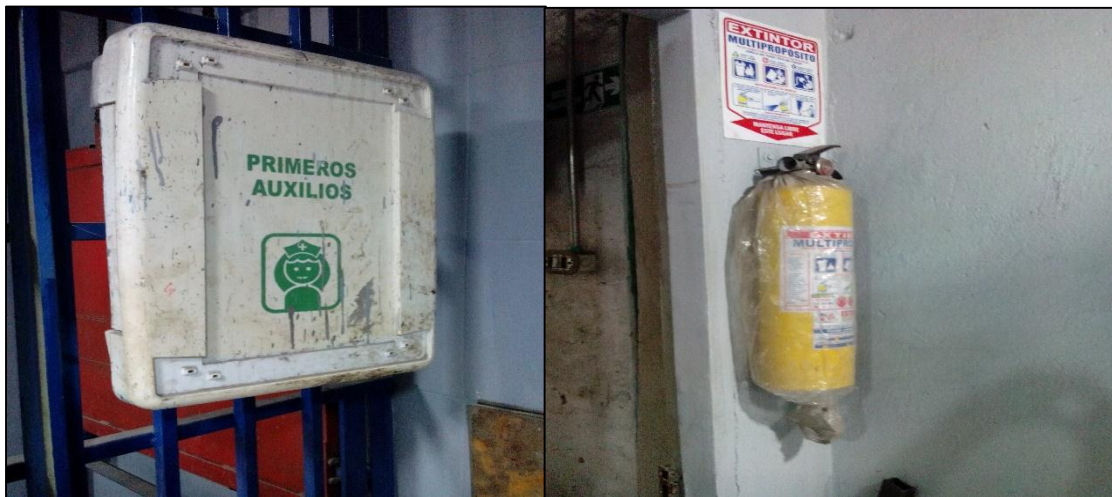
Figura 17. Recursos de emergencia en estado de deterioro. Elaboración propia
