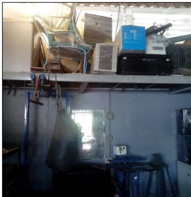
Figura 12. Malla metálica sobrecargada . Elaboración propia
