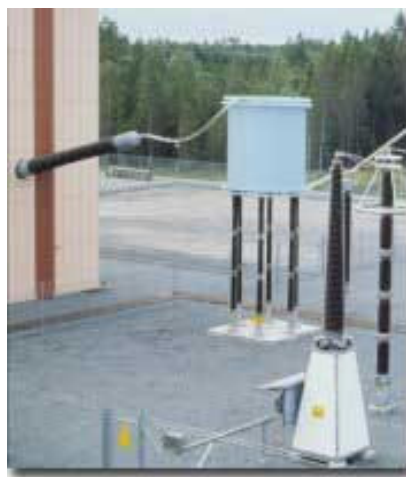
Figura 27. Reactor de alisamiento en la transmisión de HVDC de FennoSkan
