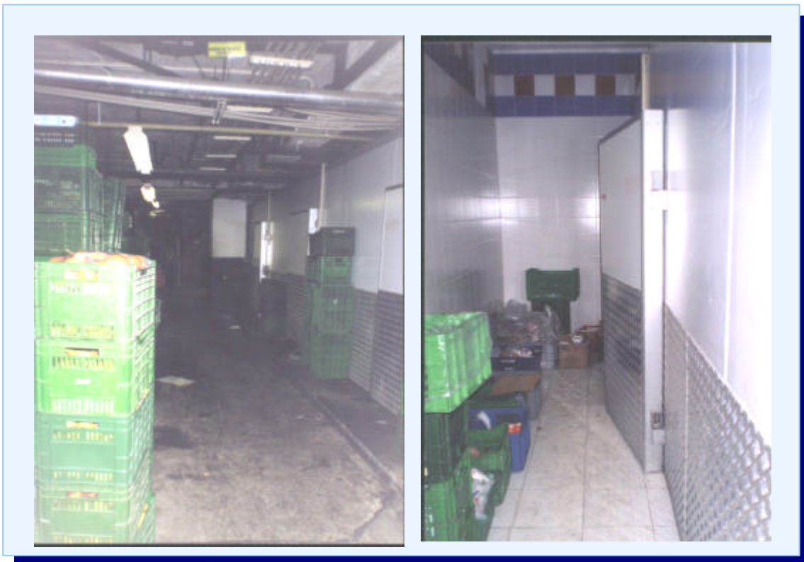
Figura 18. Pasillos de cuarto fríos
