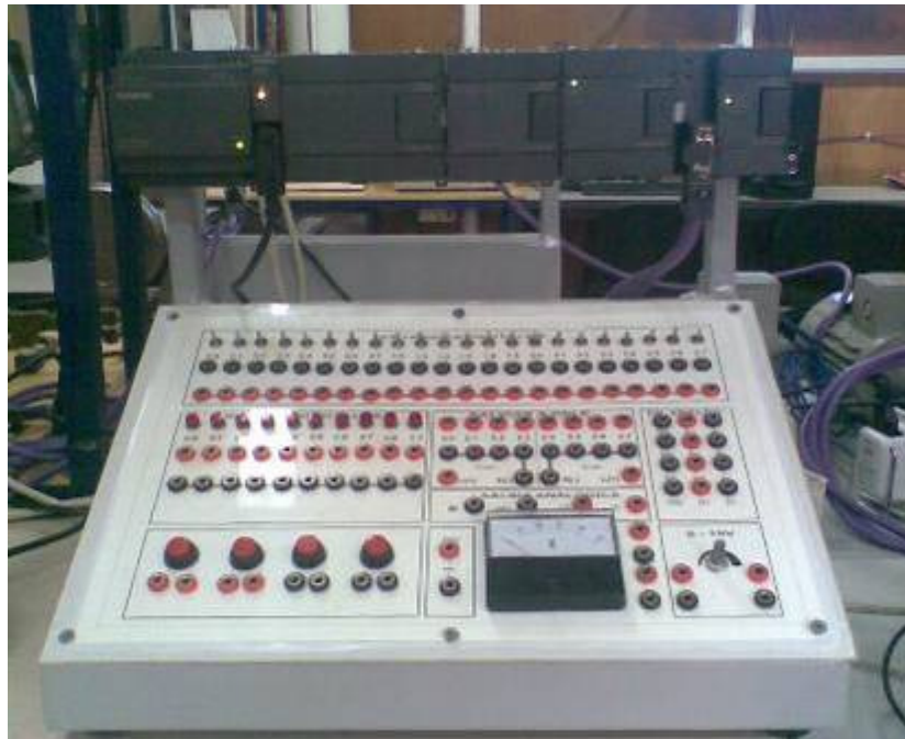
Figura 8. Banco del PLC S7-200
