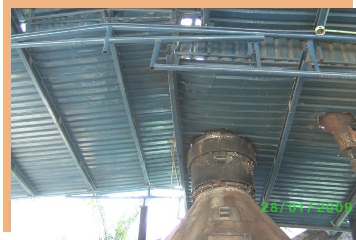
Cámara de poscombustión del horno
