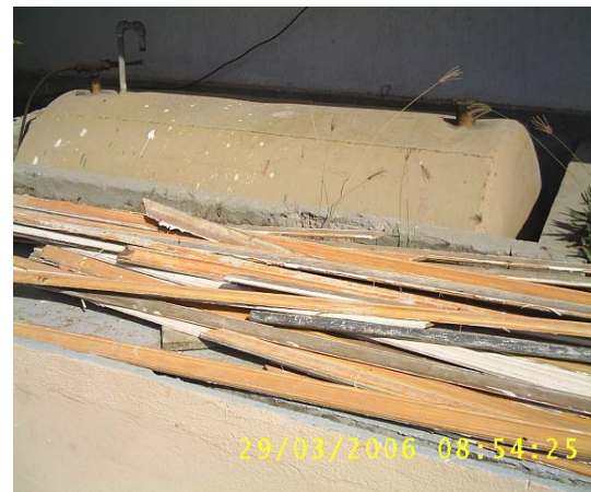
Foto 20. Tanque esta a la intemperie
