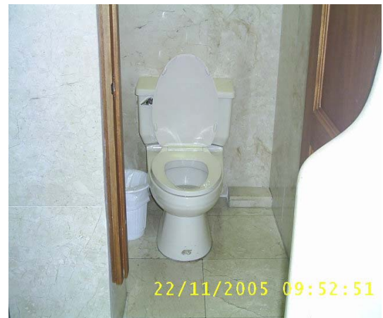
Foto 10. Sanitarios de 14 a 18 Litros.
