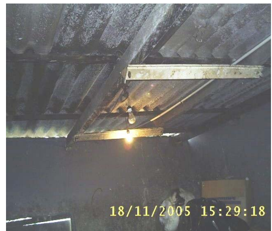
Foto 22. Mala adecuación del shut
