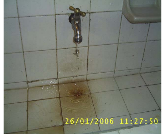
Foto 8. Gotera baño hombres 26/01/06
