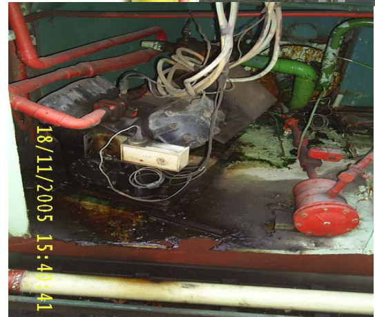
Foto 6. Mal estado de aparatos
