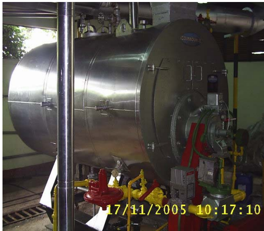
Foto 15. Caldera Piro tubular. Fuente: Autor del Proyecto
