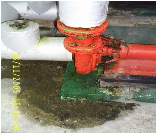
Foto 9. Goteras en bridas y empalmes.
