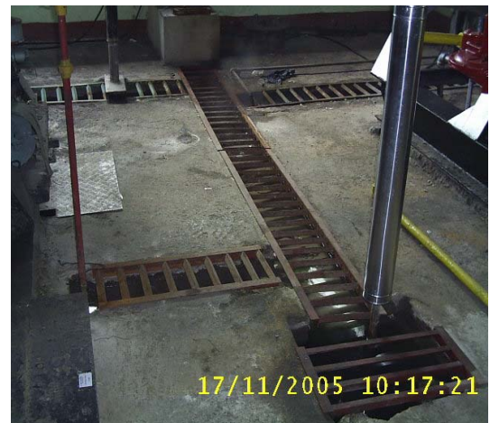
Foto 18. Desagüe de condensados Fuente: Autor del Proyecto
