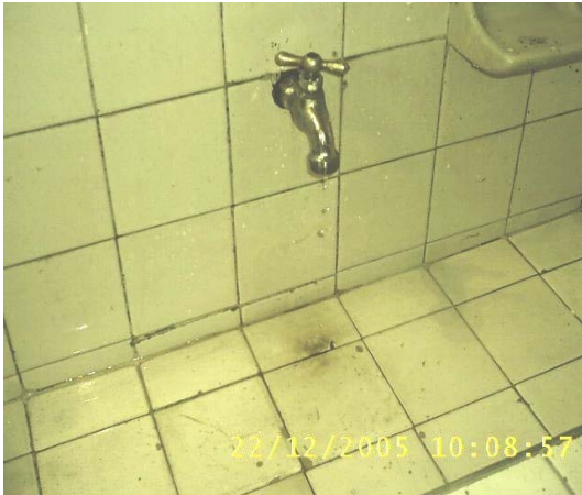
Foto 7. Gotera baño hombres 22/12/05
