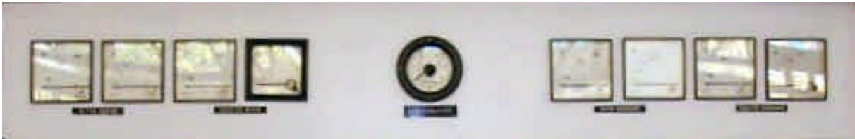
Figura 8. Panel de instrumentos de medición del banco de pruebas del grupo motor-generador de corriente continua.
