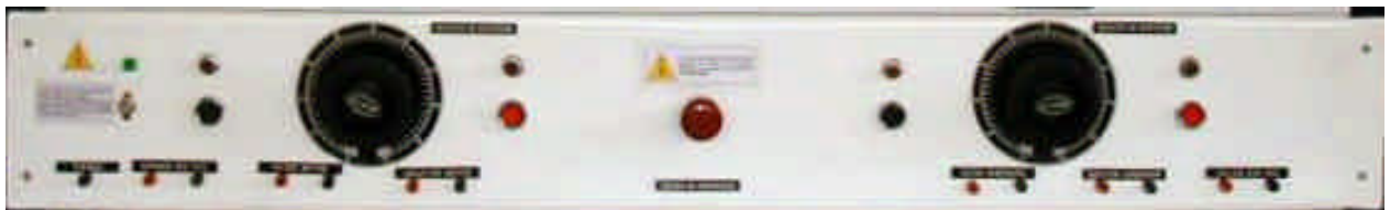
Figura 6. Panel de control y bornes de conexión del banco de pruebas del grupo motor-generator de corriente continua.
