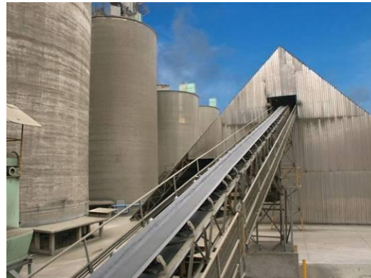
Figura 16. Sistema de Transporte de Cemento.
