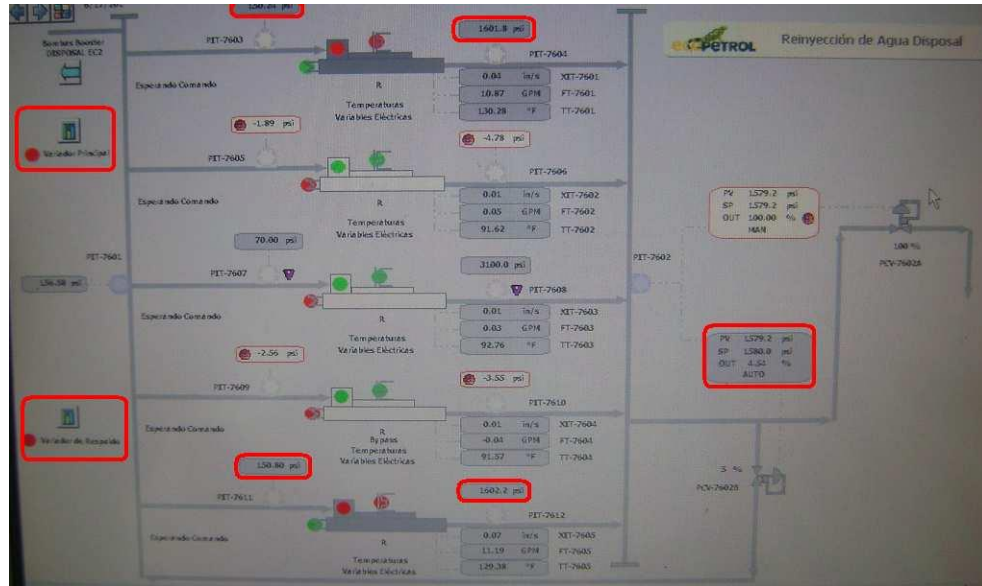
Figura 25. Arranque de bombas de Inyección.
