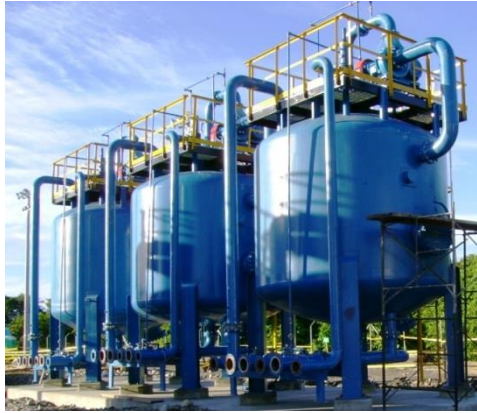
Figura 3. Sistema de filtración. (STAP 2 – Estación Castilla II)
