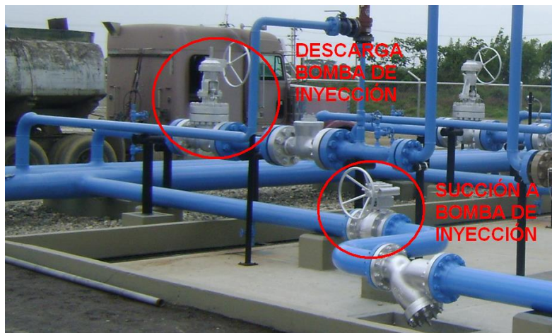
Figura 22. Válvulas de succión y descarga bombas de inyección.
