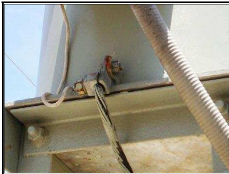
Figura 37. Corrosión de conectores [5]
