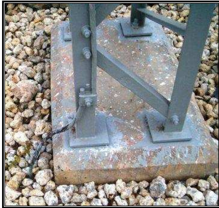
Figura 36. Conexión mecánica de conductor de tierra a estructura pintado en su totalidad [5]
