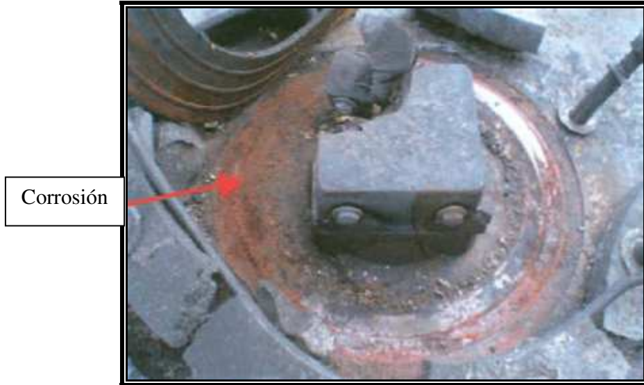
Figura 28. Oxidación En Área De Sellado [4]
