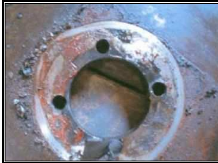
Figura 30. Oxidación En Área De Sellado En La Parte Donde Se Encontraba El Pasamuros [4]
