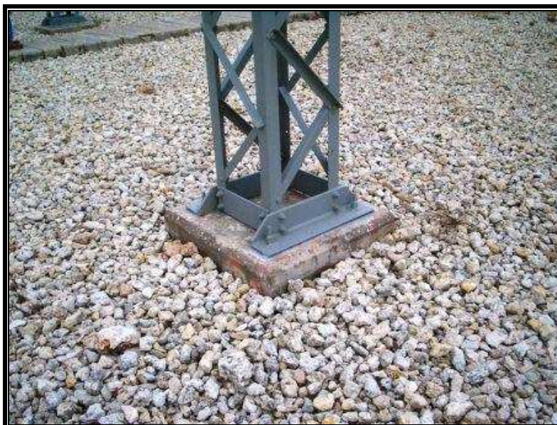
Figura 35. Estructura de aislador tipo poste, patio de 220KV sin conexión a tierra [5]
