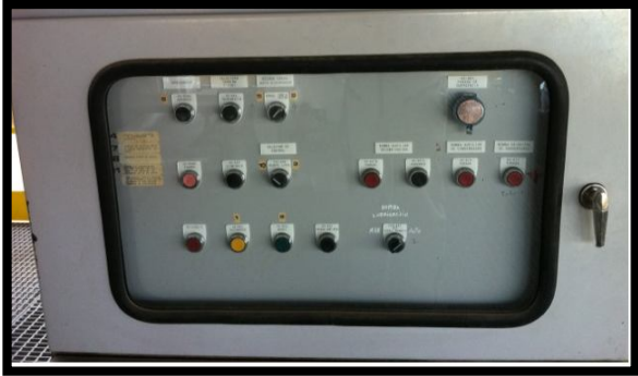
FIGURA 14. Panel Switch De Comandos.
