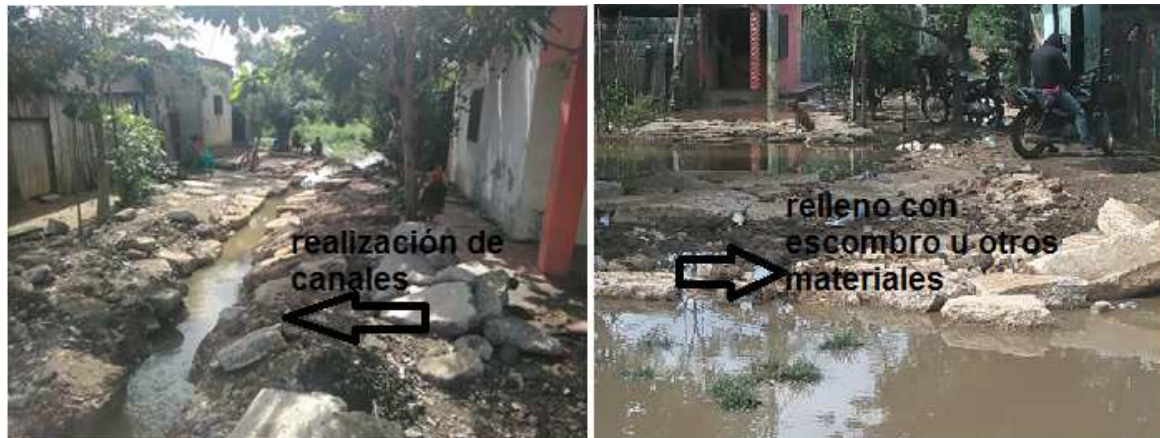
Figura 27. Estado vías en época de invierno. Fuente: registro fotográfico tomado el 18 de abril de 2017
