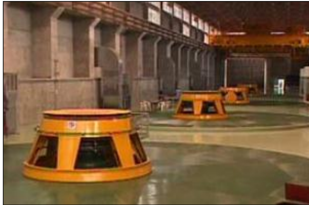
Ilustración 2. Casa de máquinas- generadores
