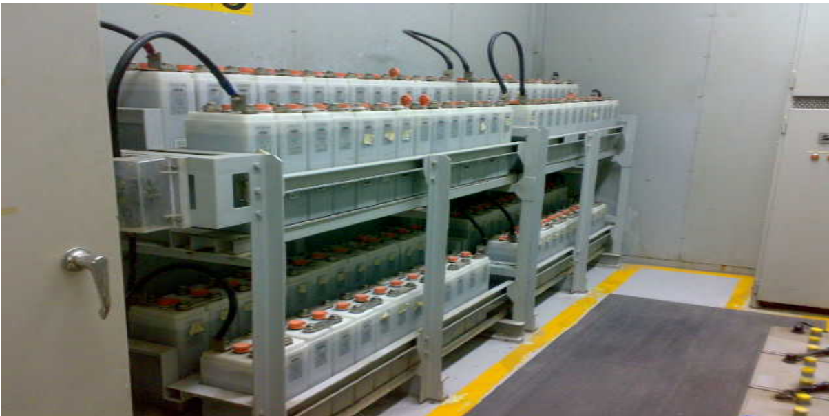
Figura 9. Banco De Baterías
