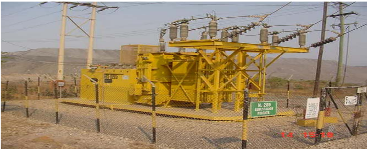
Figura 3. Subestaciones Portatiles de 7.5MVA.
