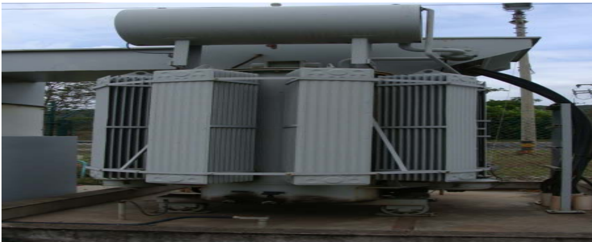
Figura 4. Transformador de Potencia.
