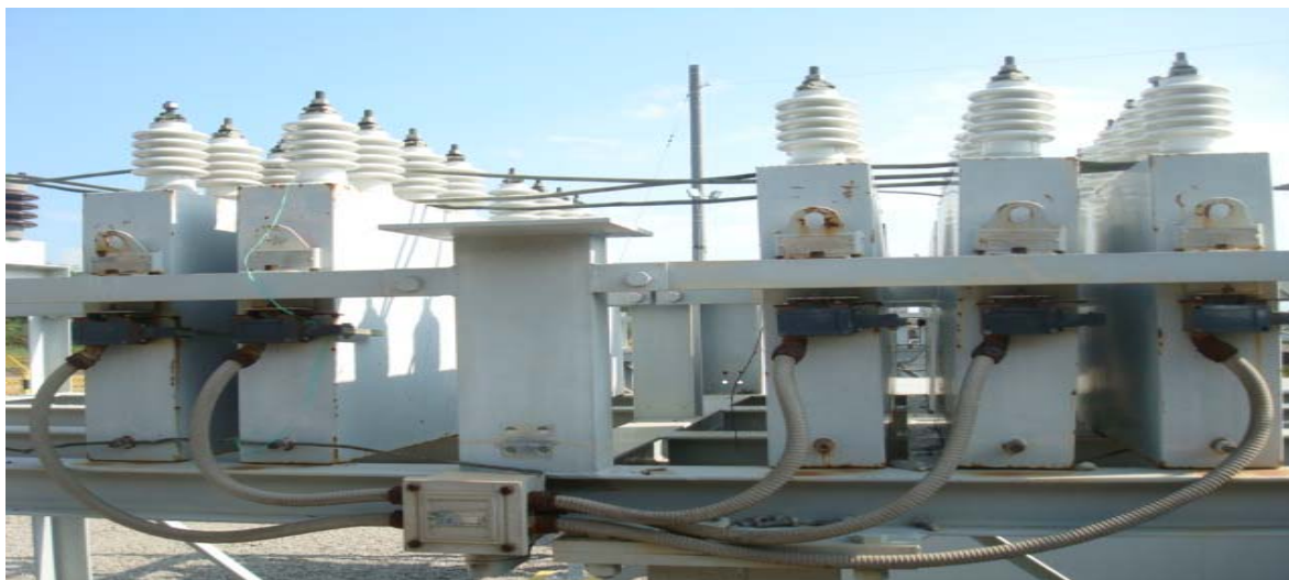
Figura 13. Bancos De Condensadores.
