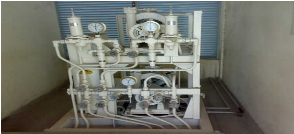
Figura 11. Sistema de Aire Comprimido.
