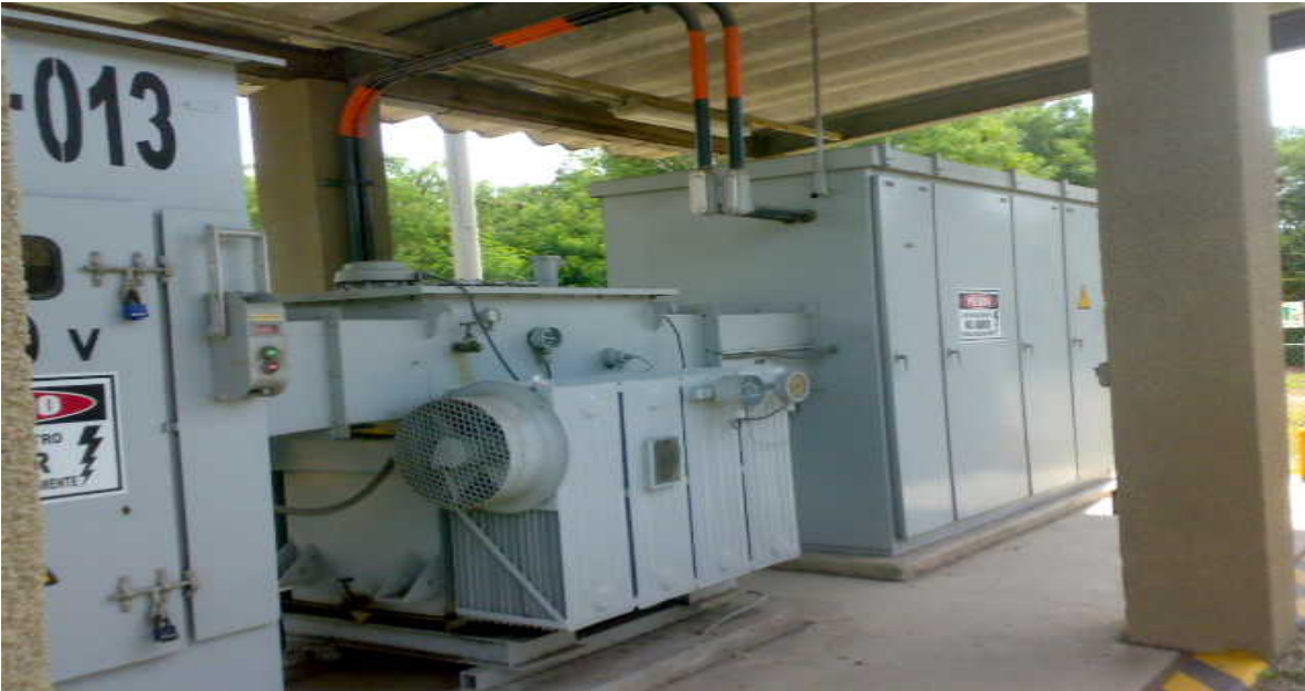
Figura 2. Subestaciones de 13.2 KV / 480 V.
