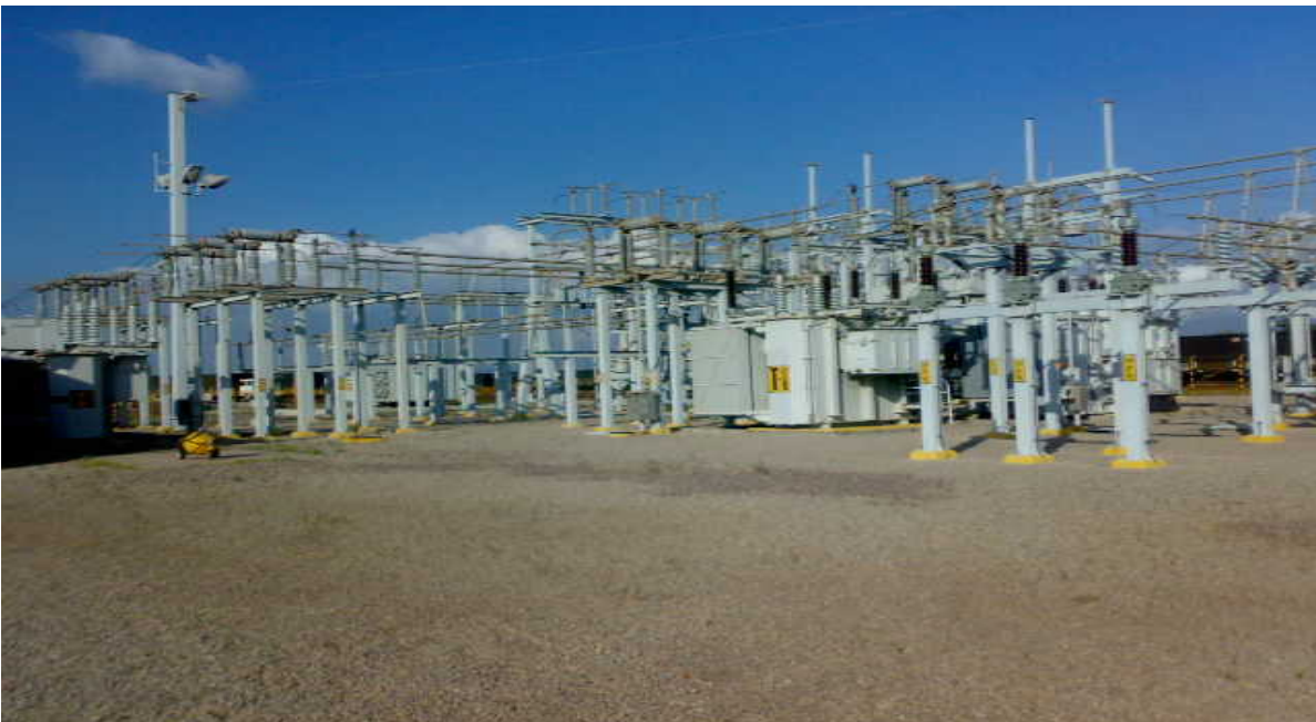
Figura 1. Subestación Principal 120 MVA.
