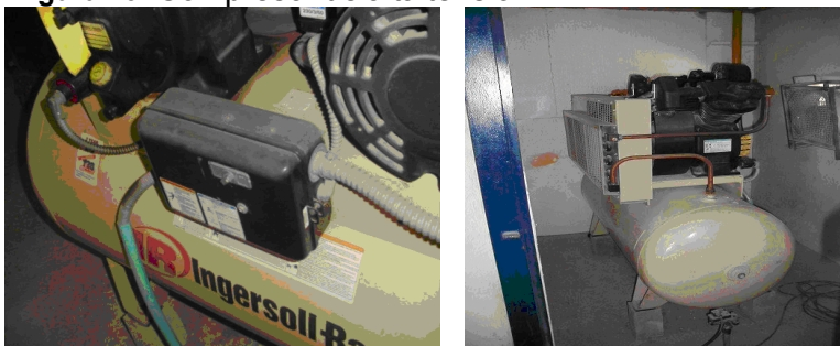
Figura 25. Compresor de alta tensión
