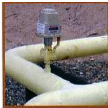
Figura 29. Transmisor inalámbrico de presión manométrica instalado en campo
