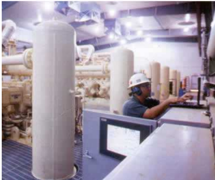
Figura 42. Sistema virtual de control en sala de maquinas
