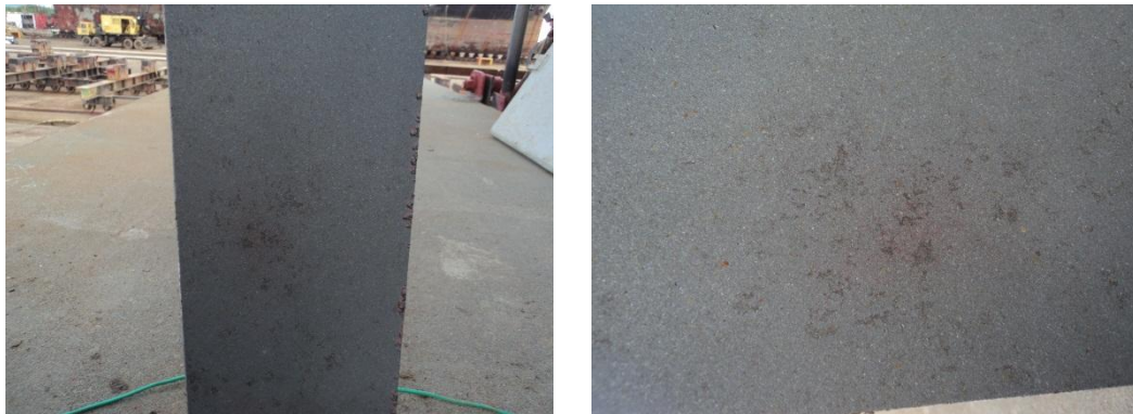
Imagen 27: Láminas nuevas expuestas a la humedad
