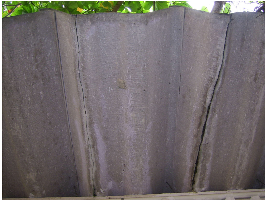
FIGURA 3.3 Estado del techo
