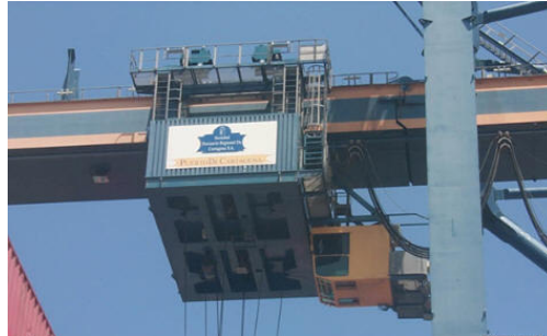
Figura 5. Cuarto de maquinas.
