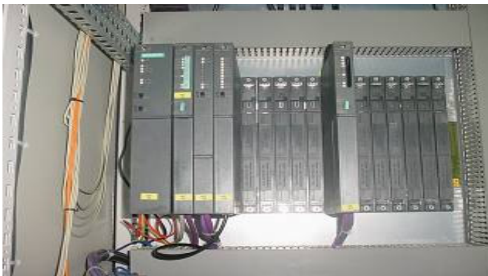
Figura 26. PLC siemens STEP7
