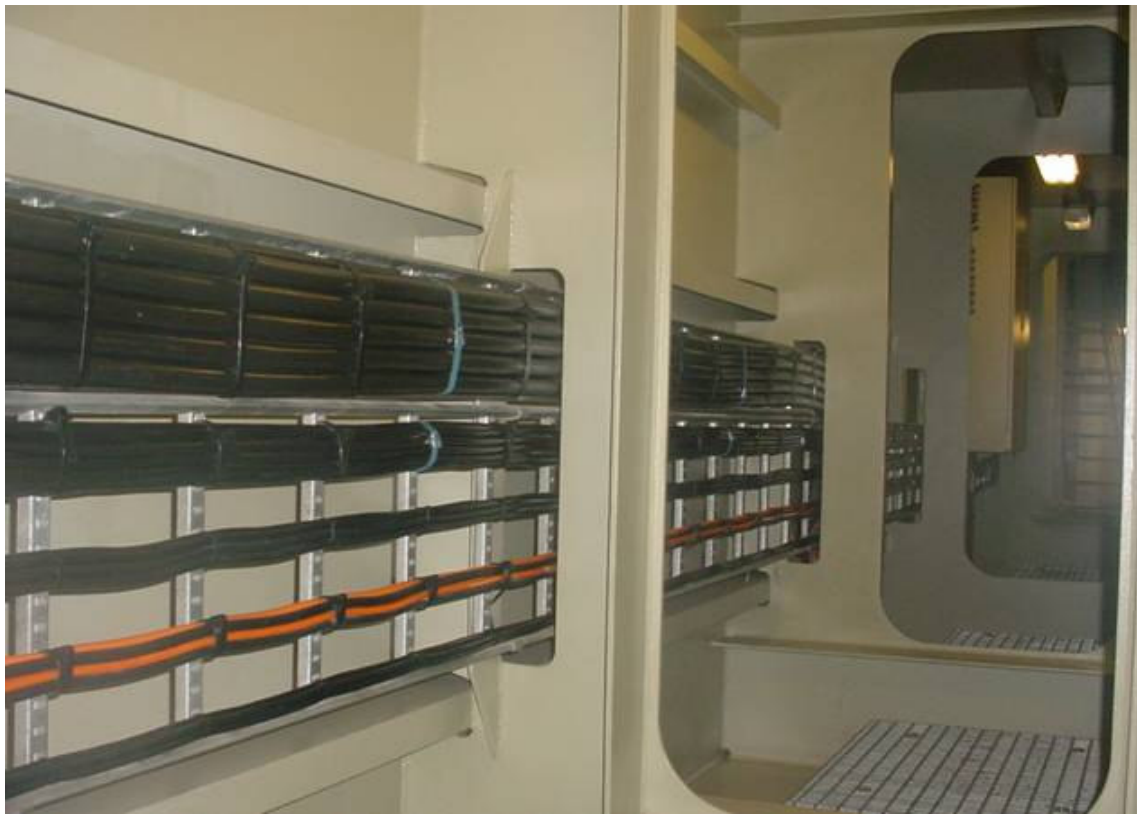
Figura 29. Cableado interno de las señales de control y potencia.
