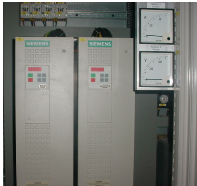
Figura 44. Variadores de velocidad
