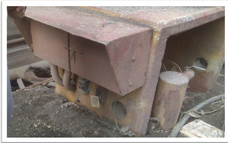
Figura 51. Mamparas de conexión.
