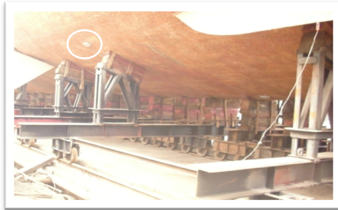
Figura 49. Protección catódica instalada.
