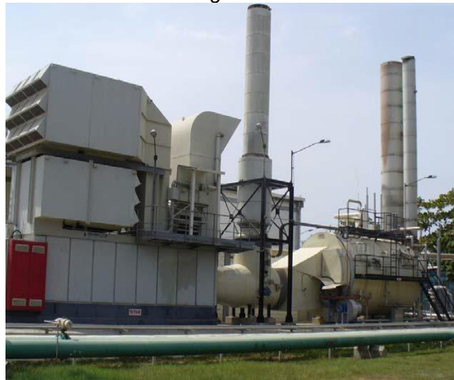
Ilustración 2.31 Planta cogeneradora N° 2 de Biofilm S.A.
