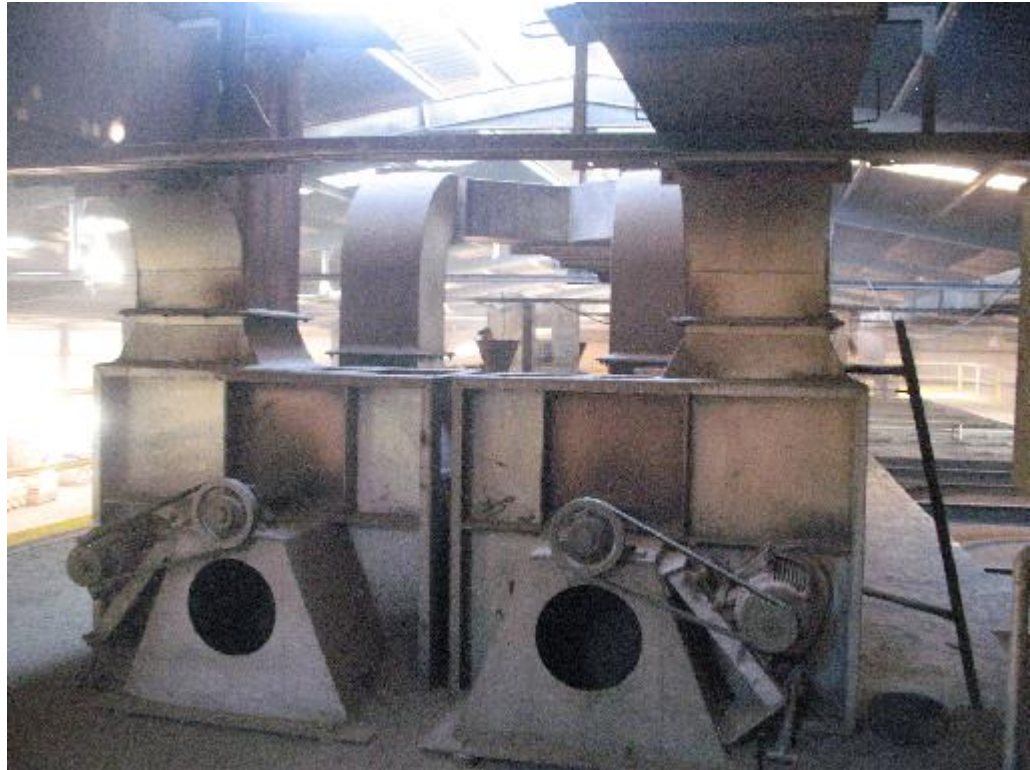
Ventiladores del Horno.
