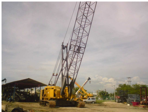
Figura 16. Grúa Lima Clark Vista Completa
