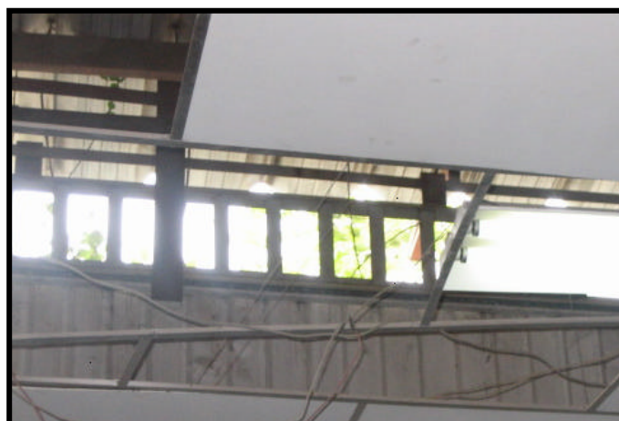
Figura 2. IMEC S.A., Almacén de Materias primas. Cielo raso averiado y cableado eléctrico sin protección y desordenado.
