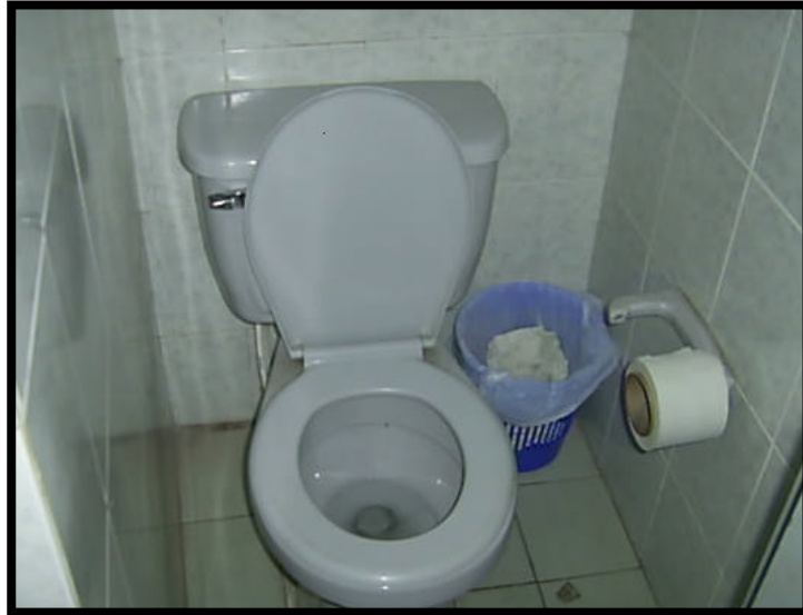
Figura 18. IMEC S.A. Sanitario del Baño de operarios.
