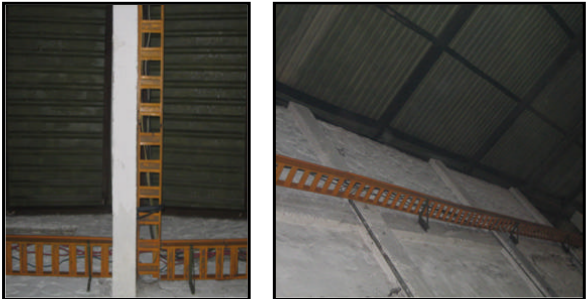
Figura 13. TMC Ltda. Bandejas eléctricas, ubicadas en la parte superior del área de producción.
