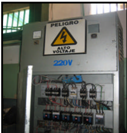
Figura 9. METALPREST Ltda. Panel de Distribución.
