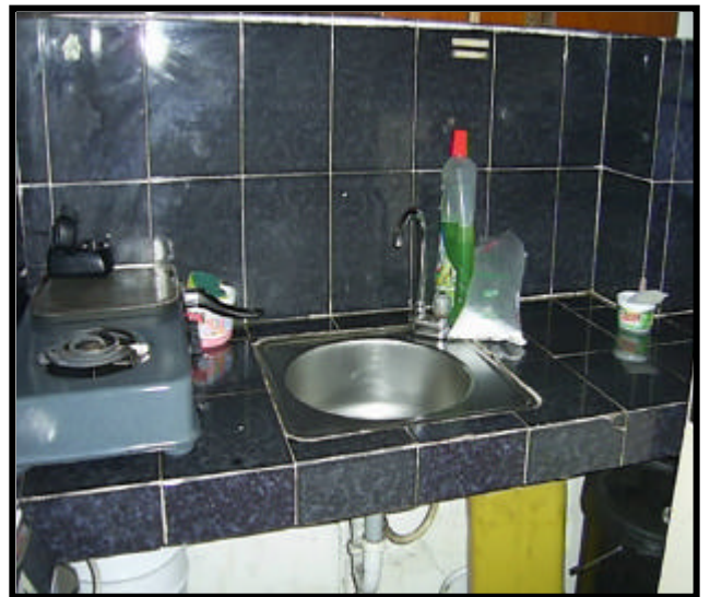
Figura 32. TMC Y CIA Ltda., cocina en el área administrativa
