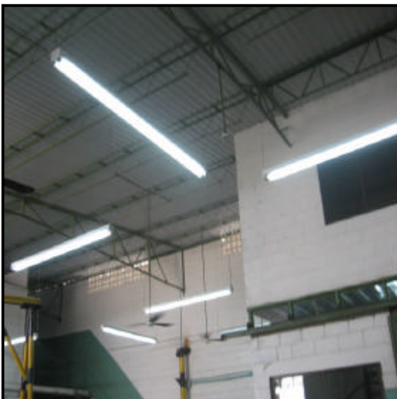
Figura 11. SERIDME Ltda. Iluminaría ubicada en el área de operaciones
