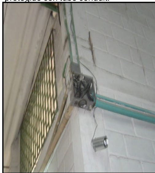
Figura 12. SERIDME Ltda. Cableado expuesto e instalación eléctrica protegido con tubo conduit.
