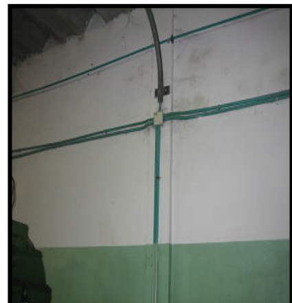
Figura 10. METALPTREST Ltda. Cableado eléctrico protegido por tubo Conduit
