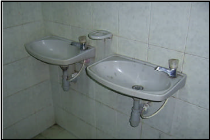
Figura 17. IMEC S.A. Lavamanos convencional del Baño de operarios.
