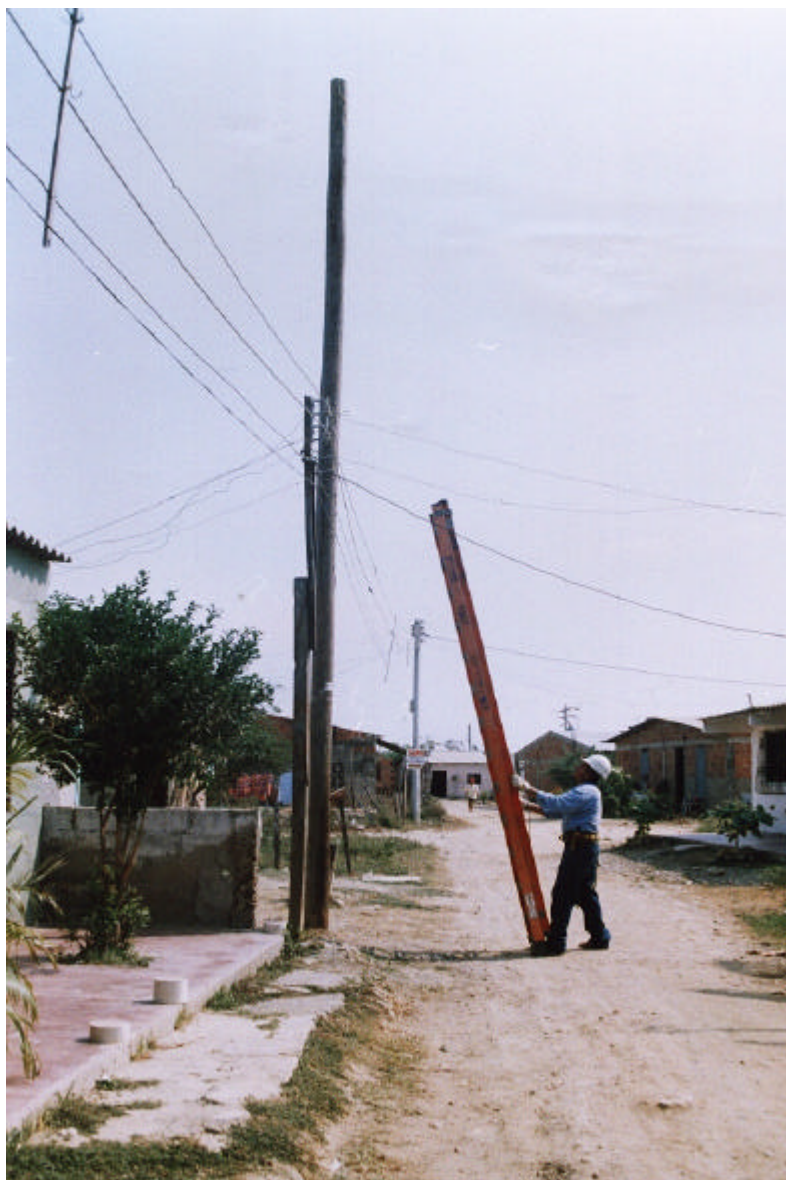
Imagen 3. Líneas eléctricas instaladas por moradores de sectores subnormales llamadas “telarañas”.
