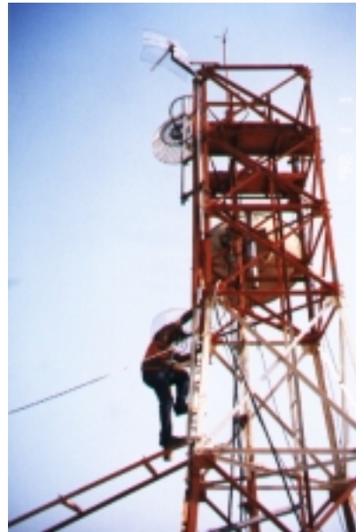
14. Torre de telecomunicaciones ubicada en el Edificio Banco de Bogota
