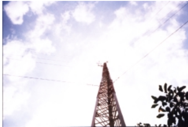
16. Torre de telecomunicación de C. I. OCEANOS
