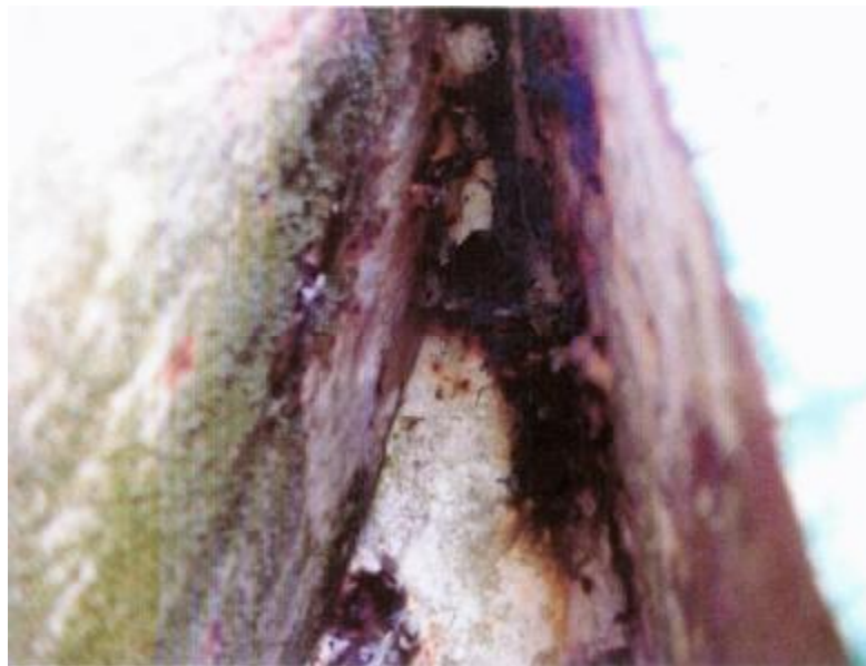
FOTO 11. EJEMPLO DE CORROSIÓN MICROBIANA
