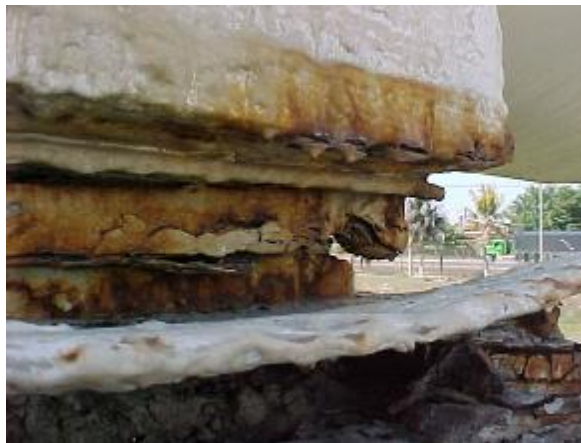
FOTO 4. EJEMPLO DE CORROSIÓN FILIFORME
