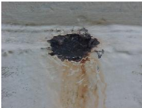
FOTO 5. EJEMPLO DE CORROSIÓN POR PICADURA
