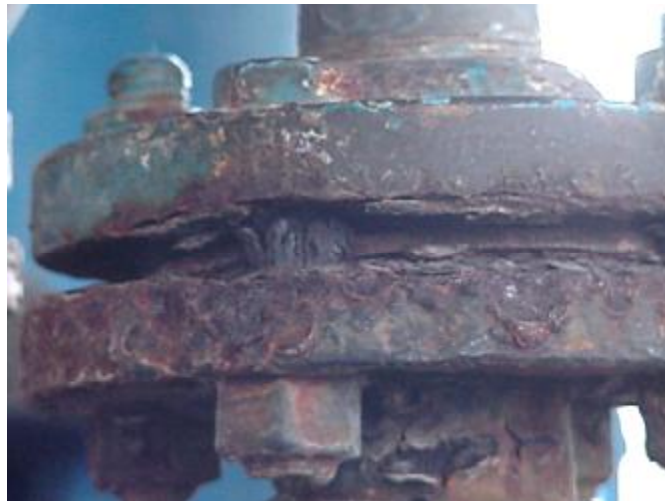
FOTO 3. EJEMPLO DE CORROSIÓN EN GRIETAS
