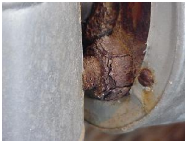
FOTO 2. EJEMPLO DE CORROSIÓN GALVÁNICA
