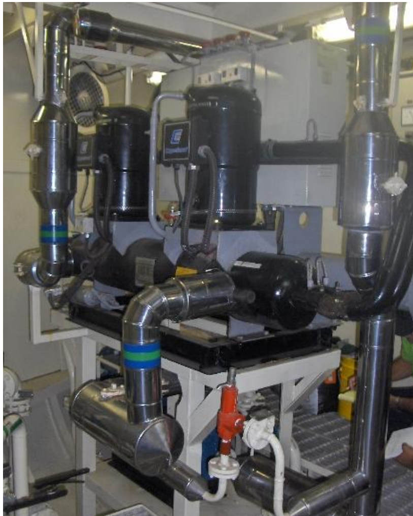
Figura 46. Unidad enfriadora de agua o “chiller”
