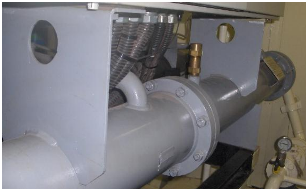
Figura 49. Condensador de la unidad enfriadora o “chiller”
