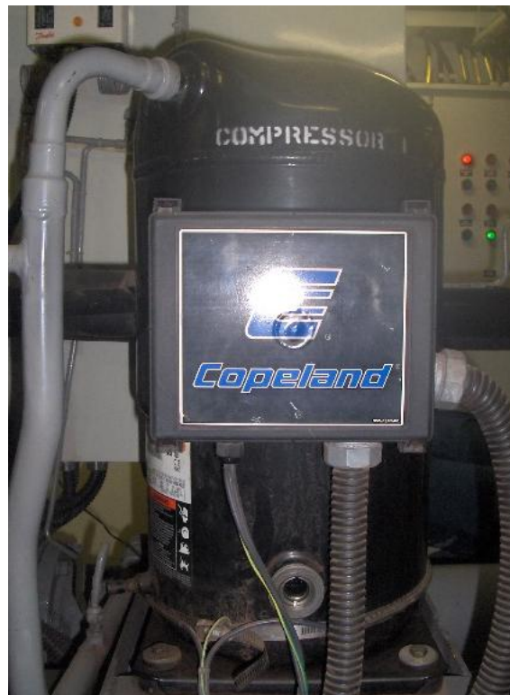
Figura 48. Compresor de la unidad enfriadora o “chiller”
