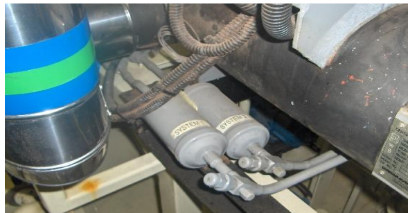
Figura 55. Filtros de la unidad enfriadora de agua o “chiller”
