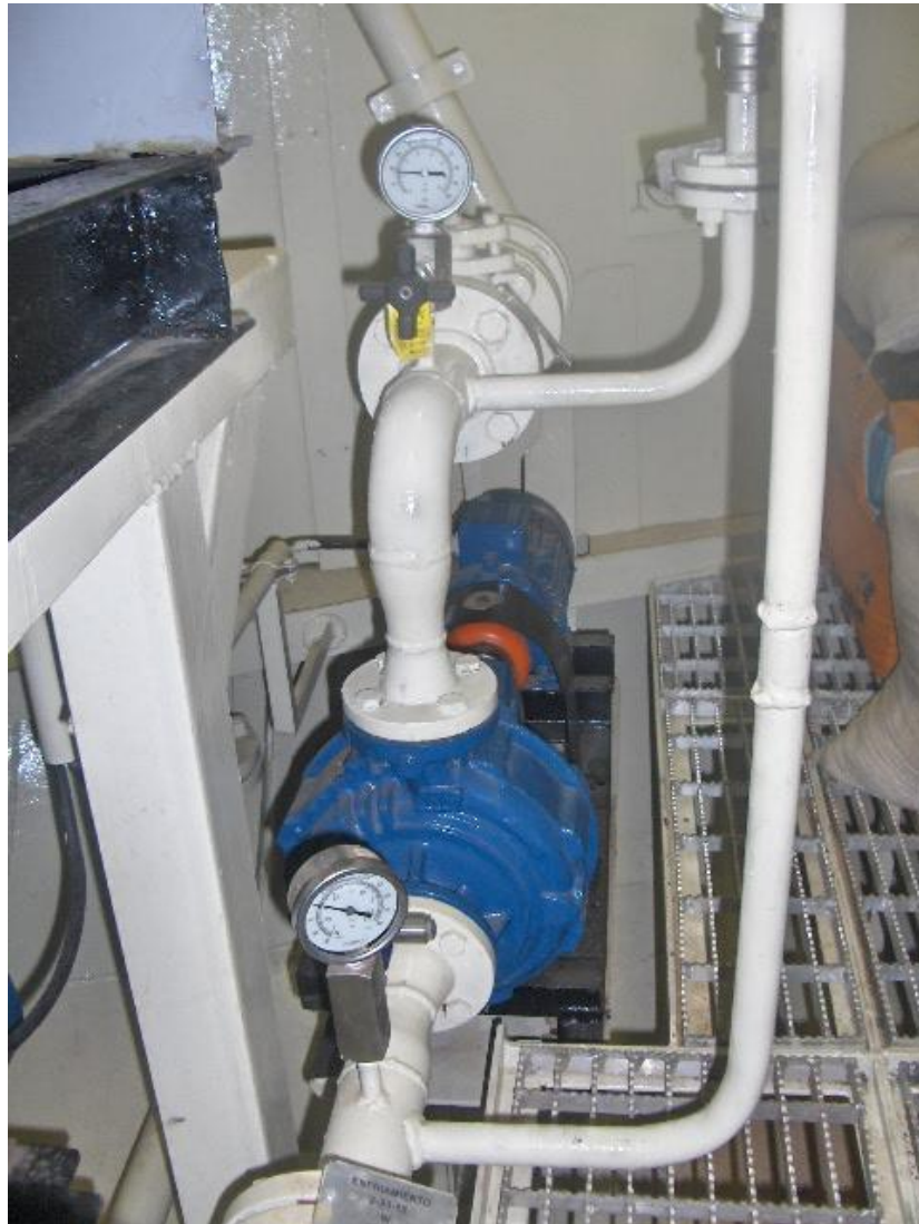
Figura 52. Bomba de enfriamiento de la unidad enfriadora de agua o “chiller”
