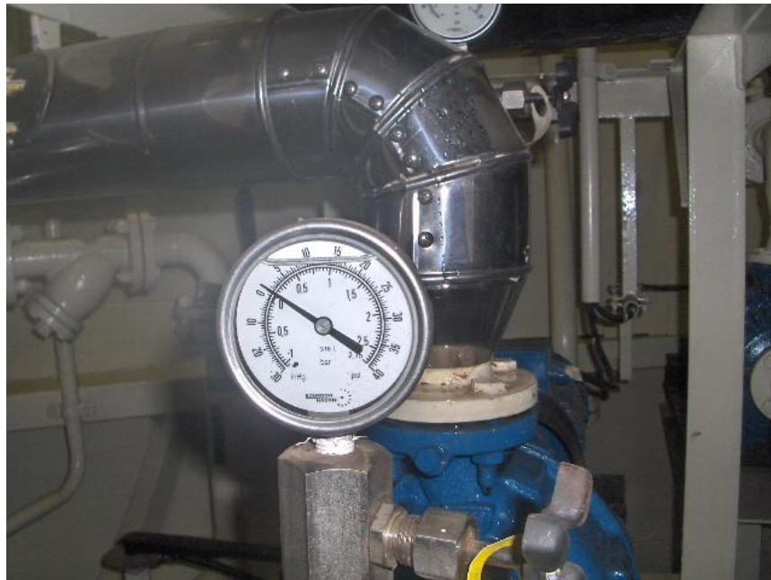
Figura 58. Manómetro de la bomba de circulación de la unidad enfriadora
