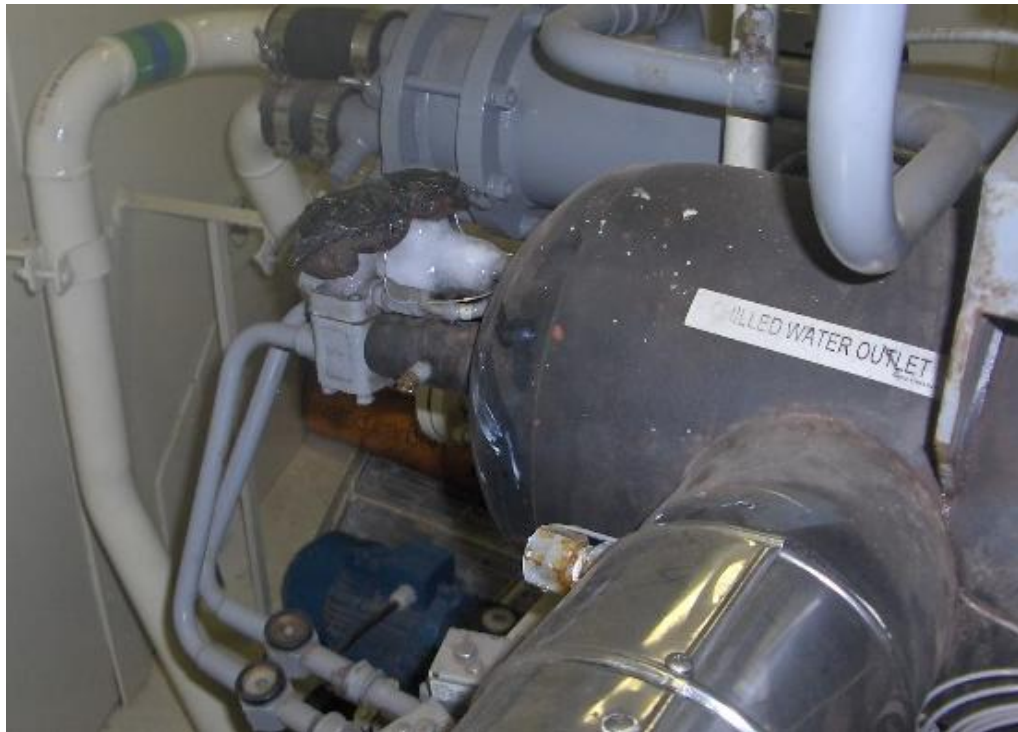
Figura 50. Válvula de expansión de la unidad enfriadora o “chiller”
