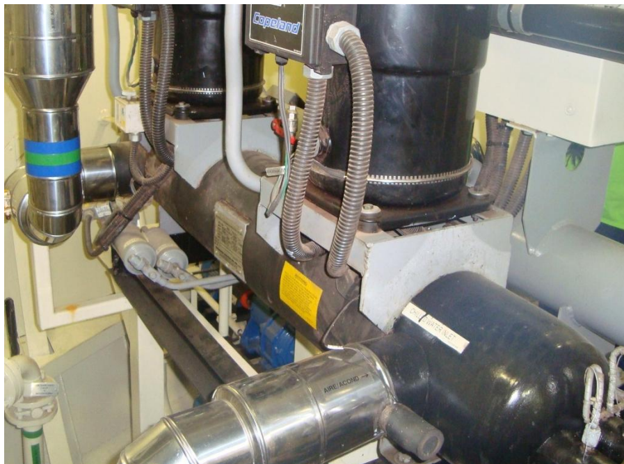
Figura 47. Evaporador de la unidad enfriadora o “chiller”
