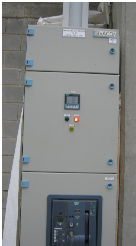
Figura 4. Tablero de distribución de Energía
