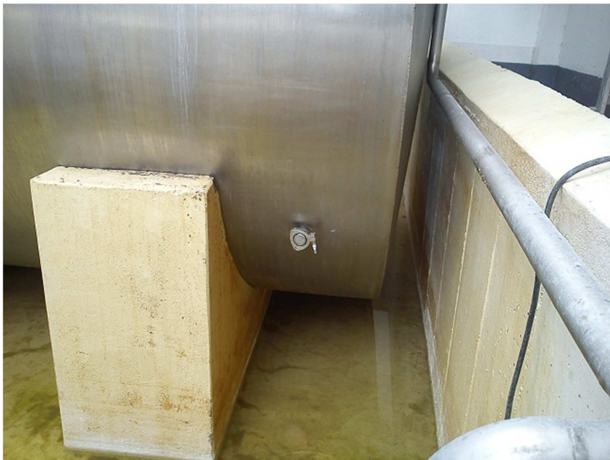
Figura 19. Ubicación inicial del transmisor de nivel
