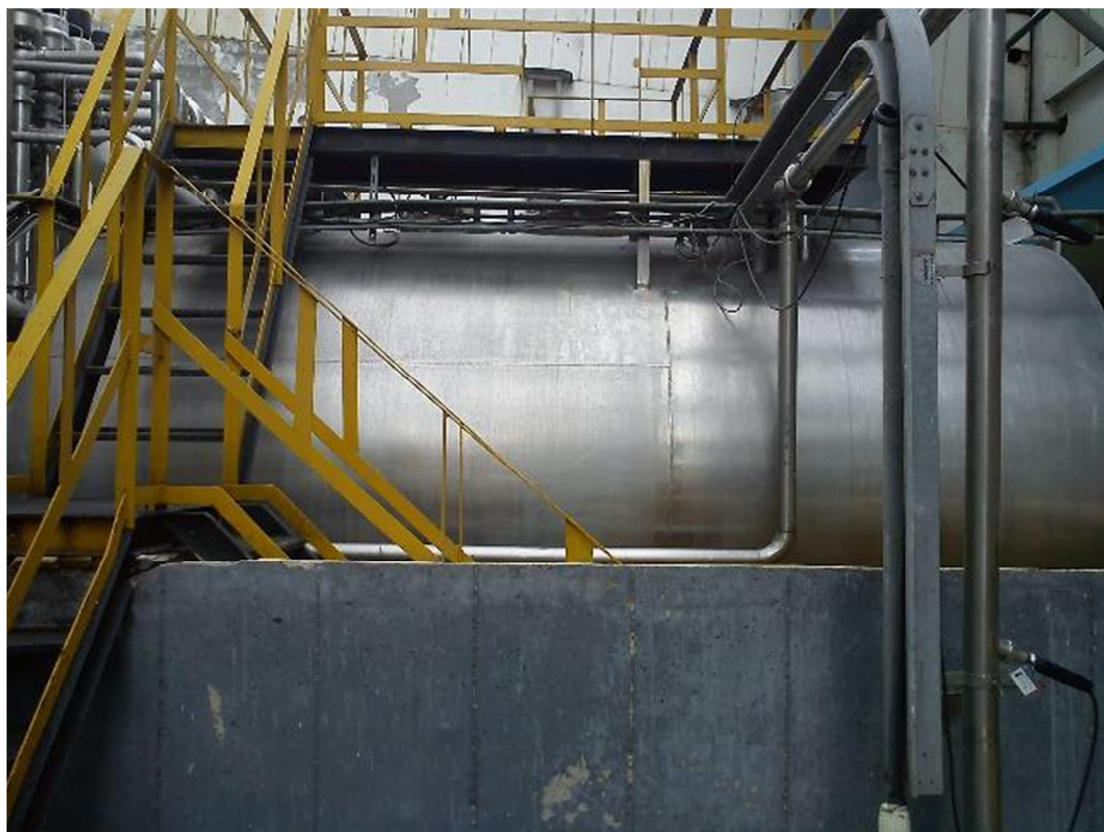
Figura 28. Tanque de neutralización
