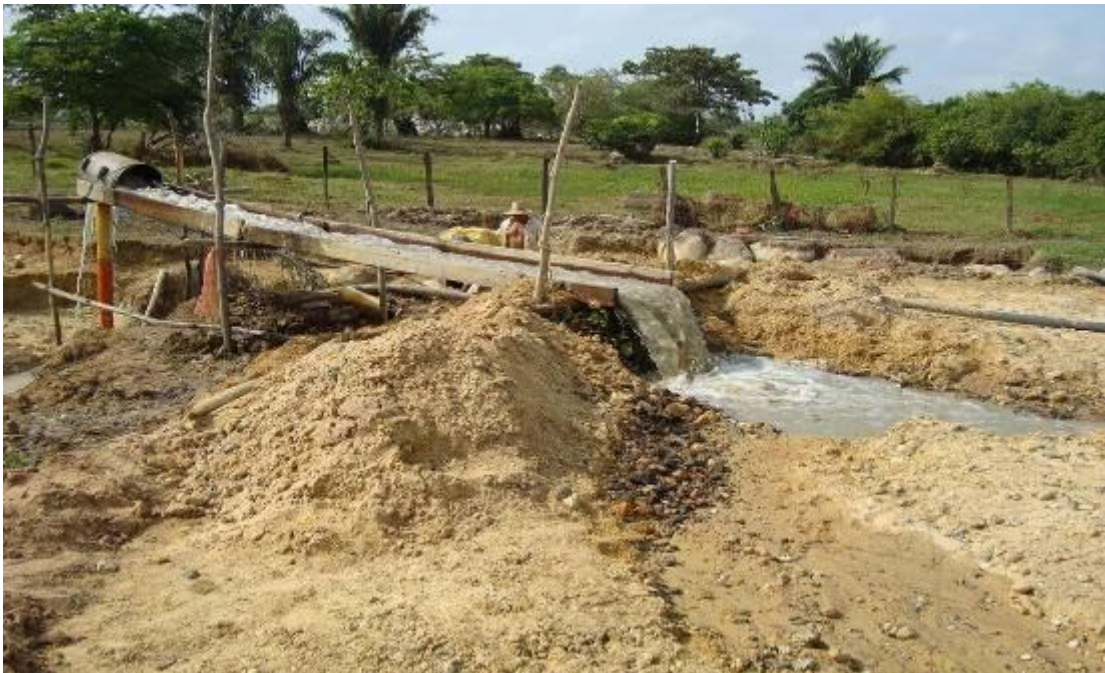
Figura 16: Sistema de elevadora
