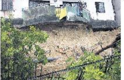
El muro de contención del 9 de Abril en la Manzana G del Mirador de Zaragocilla se está destruyendo por la acción de las lluvias. Se ve el muro de contención que se estaba construyendo en la zona.
