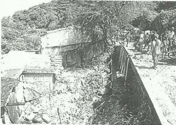
En la tercera subida de La Popa, cuatro viviendas están afectadas por las corrientes pluviales. La más averiada fue la de la familia Ayala.
