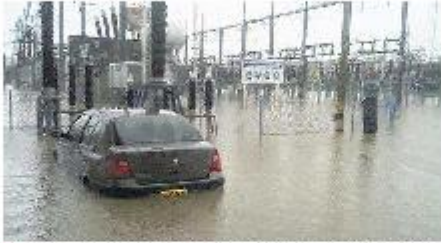
Las subestaciones de energía de Cartagena también se vieron afectadas por el agua que inundó que cayó sobre la ciudad.
