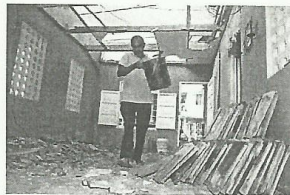
En la Calle Uribe Uribe, de Torices, la casa de la familia De la Rosa perdió parcialmente el techo.
