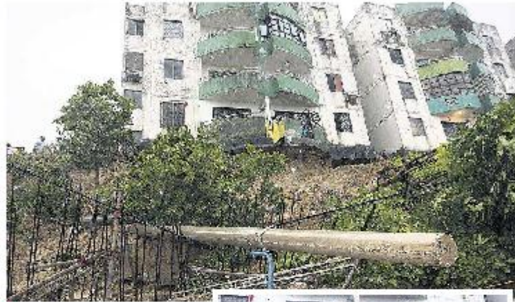
El muro de contención del 9 de Abril en la Manzana G del Mirador de Zaragocilla se está destruyendo por la acción de las lluvias. Se ve el muro de contención que se estaba construyendo en la zona.
