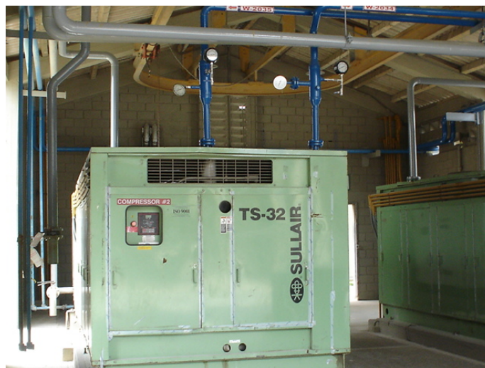
Figura 6. Compresor CM-6U al lado del compresor CM-7U
