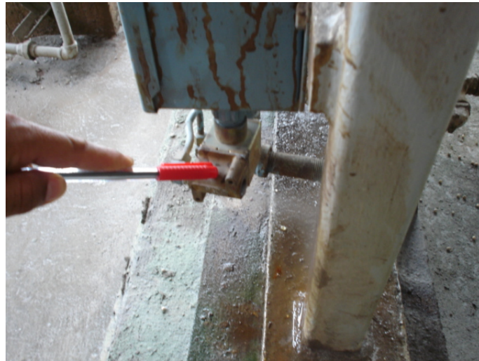
Figura 4. Fuga en una trampa de condensado
