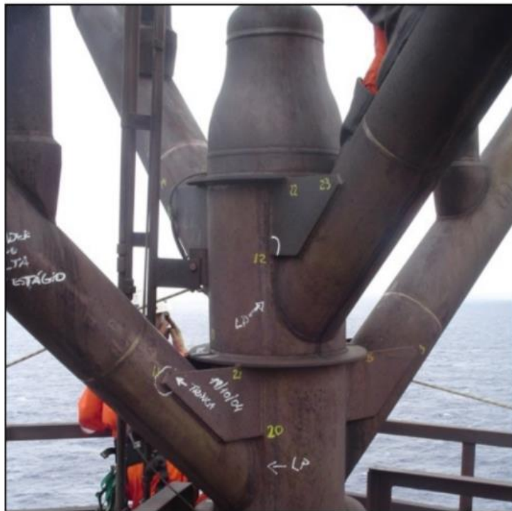
Figura 12. Grietas en uniones soldadas de soportes de tubería principal. (Fernando B. Mainier et al., 2016).
