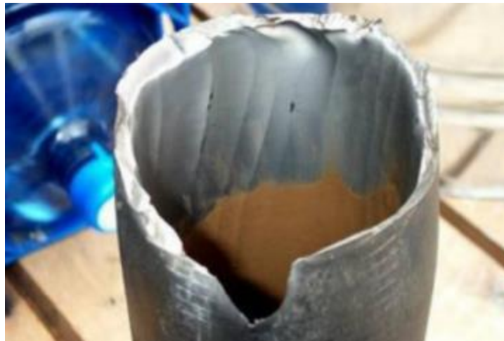
Figura 7. Oléoducto después de ser atacado por el agrietamiento por corrosión bajo tensión o SCC. (Popoola et al., 2013)
