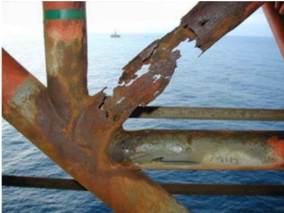
Figura 8. Destrucción debido a corrosión en plataforma offshore. (Starokon, 2020).
