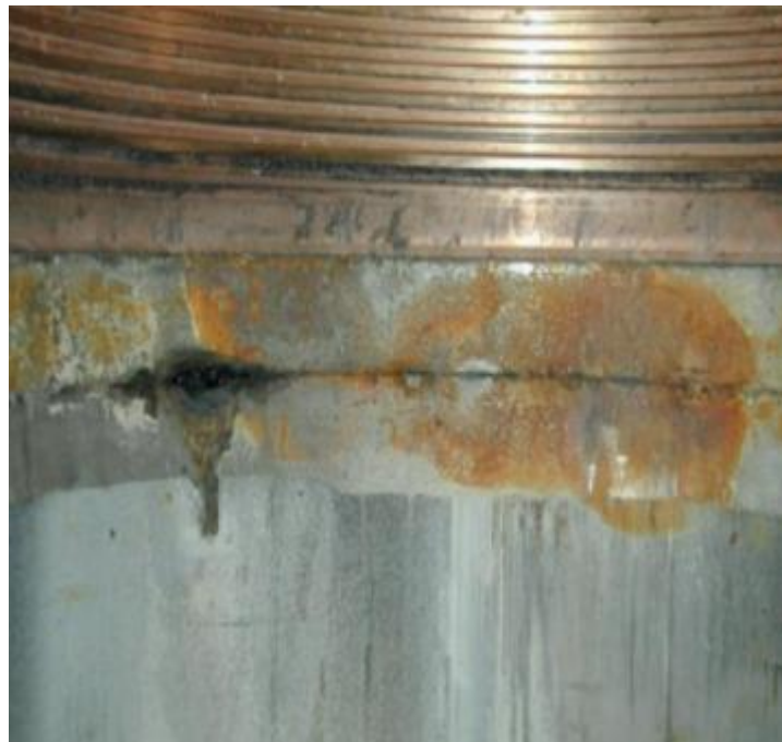
Figura 6. Oléoducto bajo los efectos de la corrosión por picaduras o pitting.
