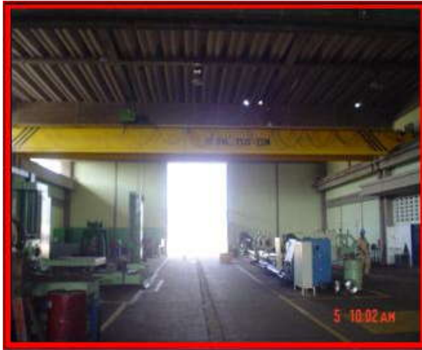
FIGURA 4. PUENTE GRUA BIRRIEL
