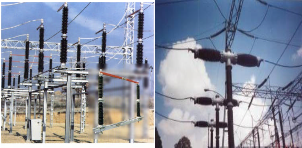
Figura 2.9 Seccionador de alta tension
