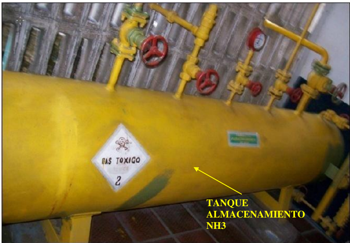
Figura 17. Foto tanque NH3
