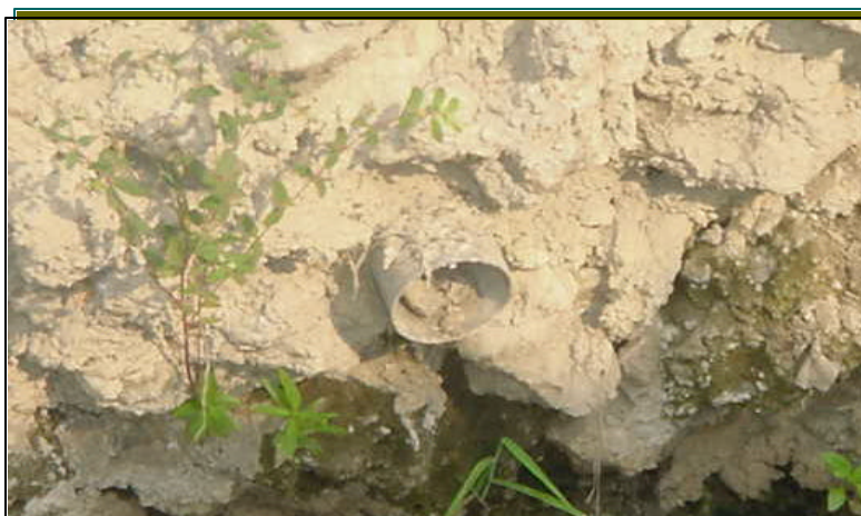
Figura 14. Punto de vertimiento del sistema de tratamiento No. 4
