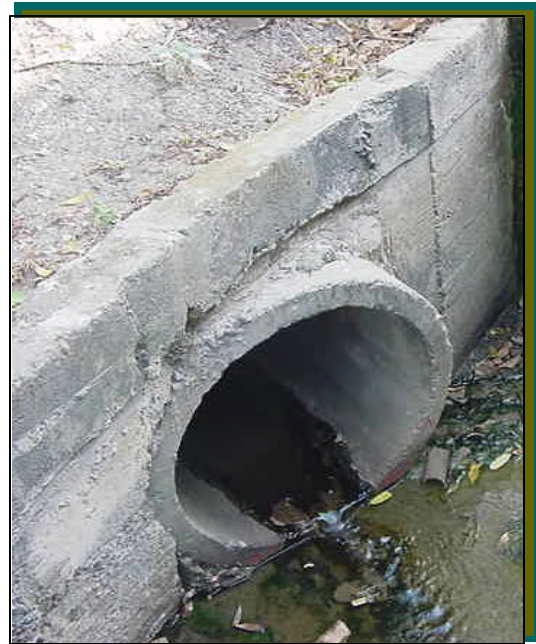
6 Figura 9. Punto de vertimiento 7 del sistema de tratamiento No. 2
