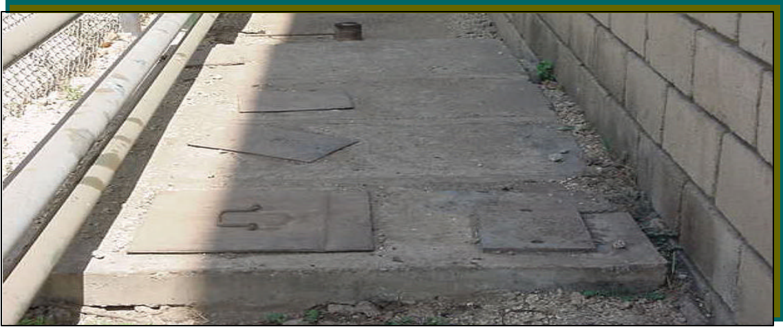
Figura 10. Tanque séptico y filtro anaeróbico sistema de tratamiento No. 3
