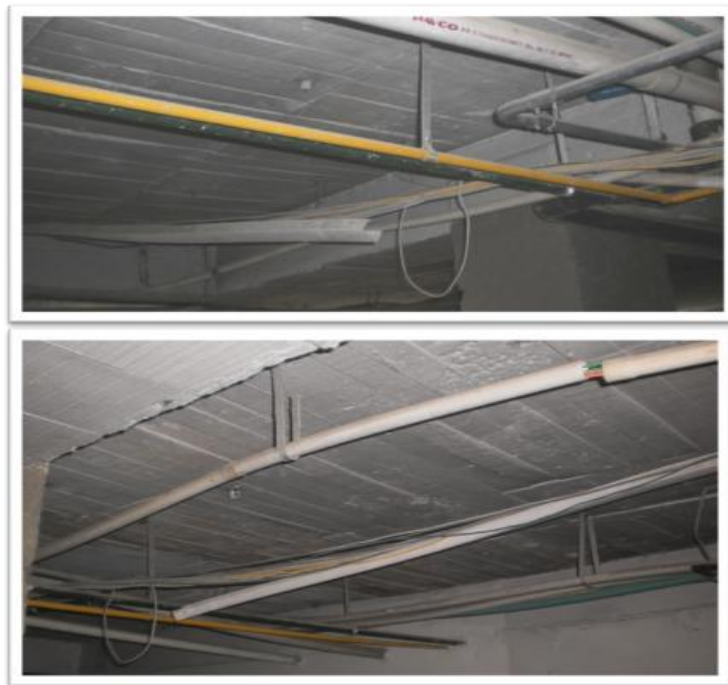
Figura 5. Estado actual de los cables en las canaletas.
