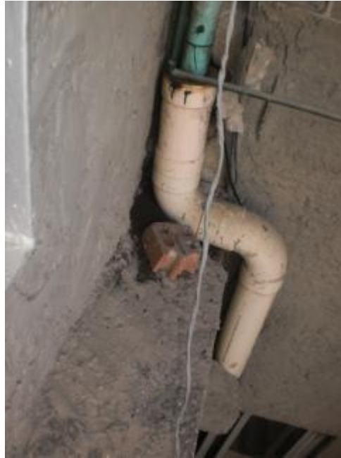
Figura 9 Cableado UTP no canalizado.
