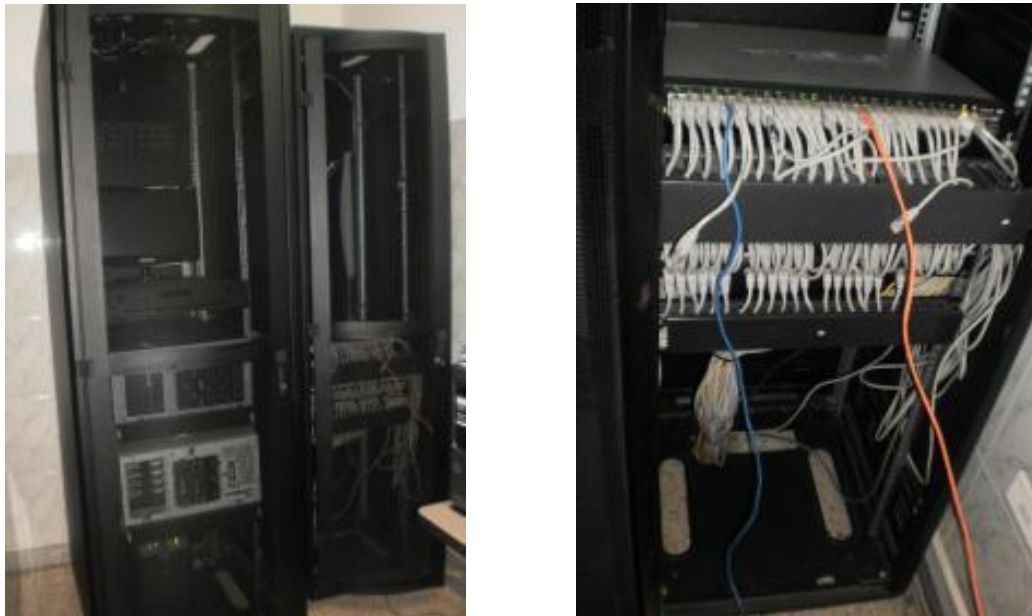
Figura 1. Gabinetes de Servidores y Switches
