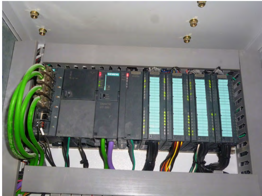
Figura 12. PLC SIMATIC S7-300 marca SIEMENS .
