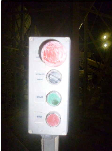
Figura 10. Estación remota de mando
