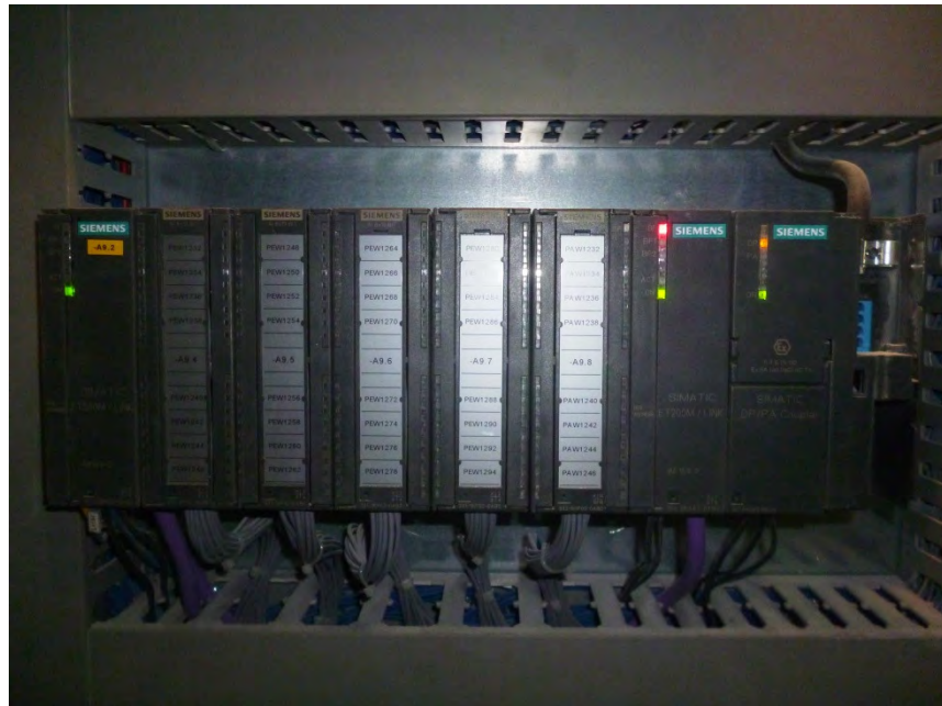
Figura 15. MODULO I/O TABLERO RIO 03 SIMATIC ET - 200M PERIFERIA DECENTRALIZADA EN CAMPO.
