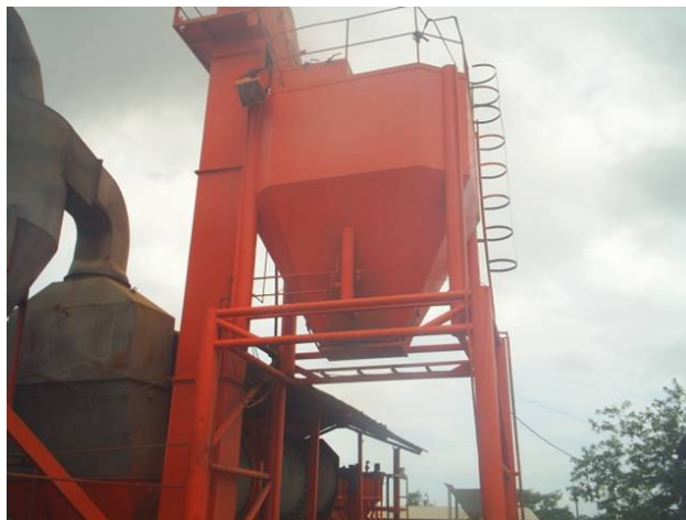
Figura 19. Elevador, Homogenizador y Silo de almacenamiento
