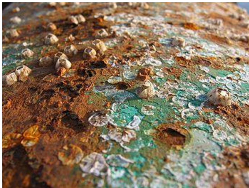
Figura 1. Oxidación del metal
