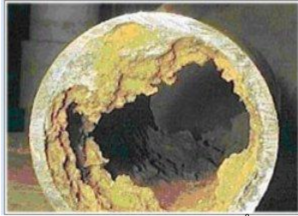
Figura 2. Corrosión por picadura 8
