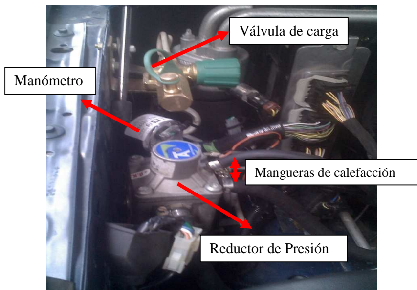
Figura 3.1 Ubicación de Reductor, Válvula de Carga y Manómetro en Motor
