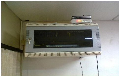
Figura 4. Rack de Comunicación - Pared
